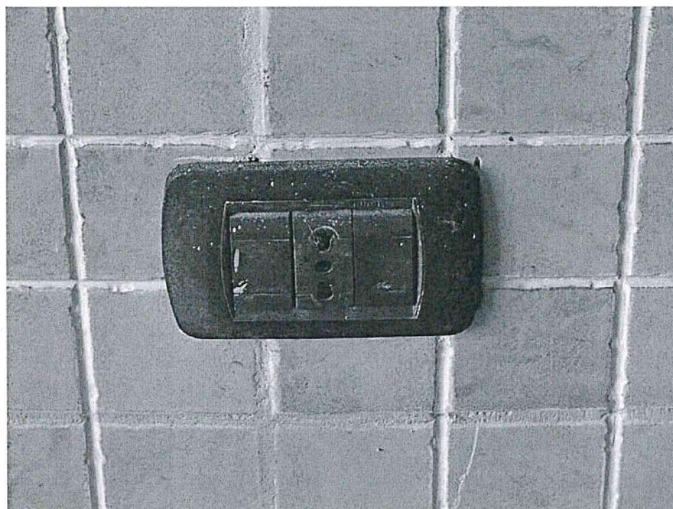
Dettaglio - Frutti elettrici
