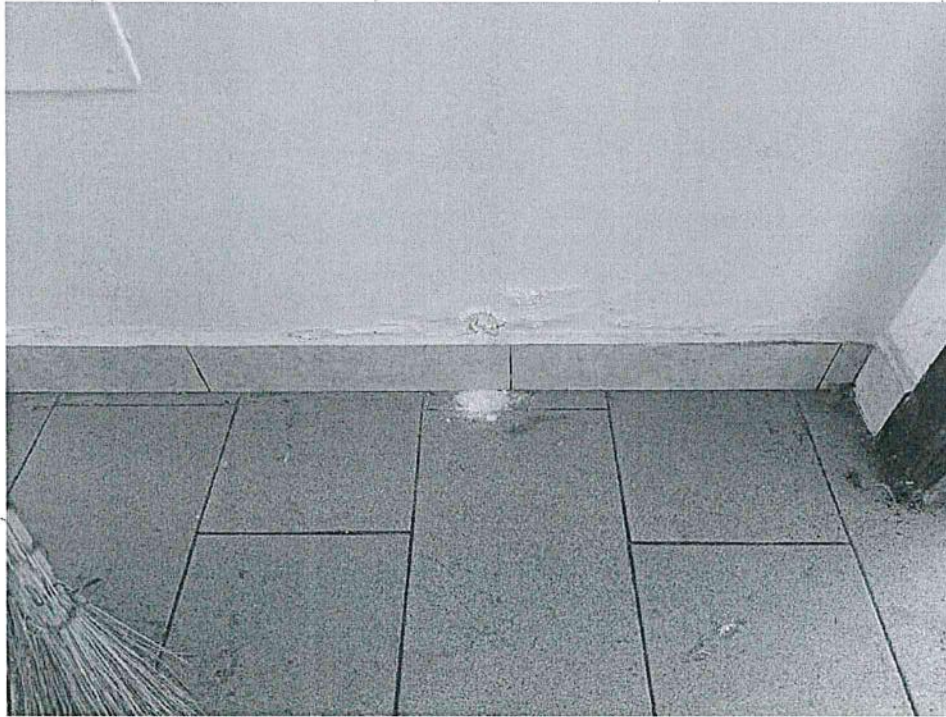
Dettaglio - Umidità muri
