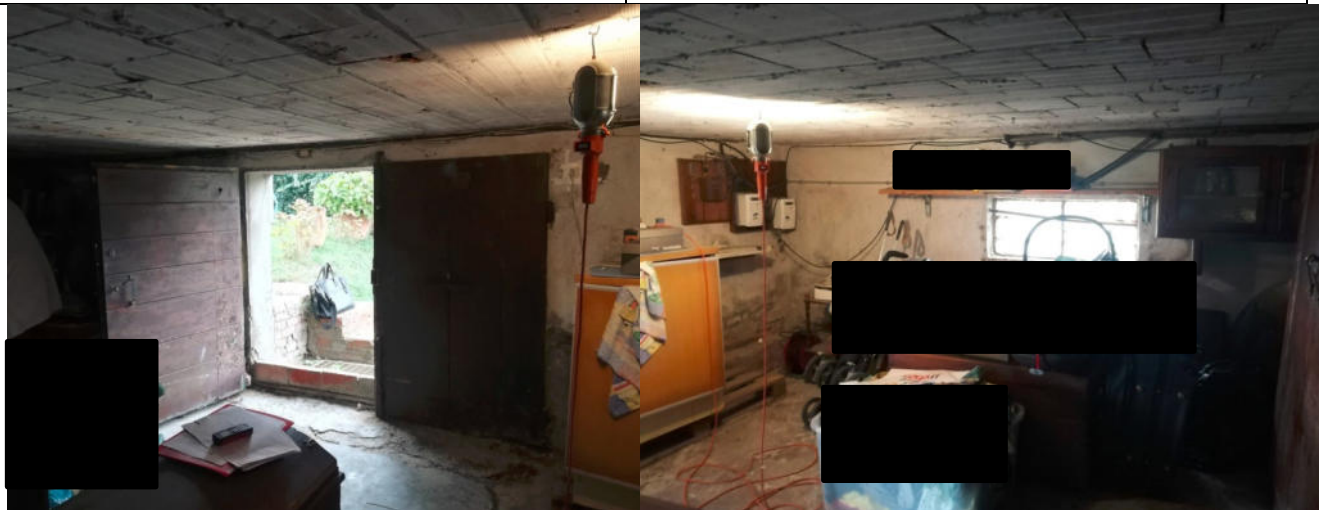
cantina piano seminterrato con soffitto stonacato in laterizio e pavimento a cemento
