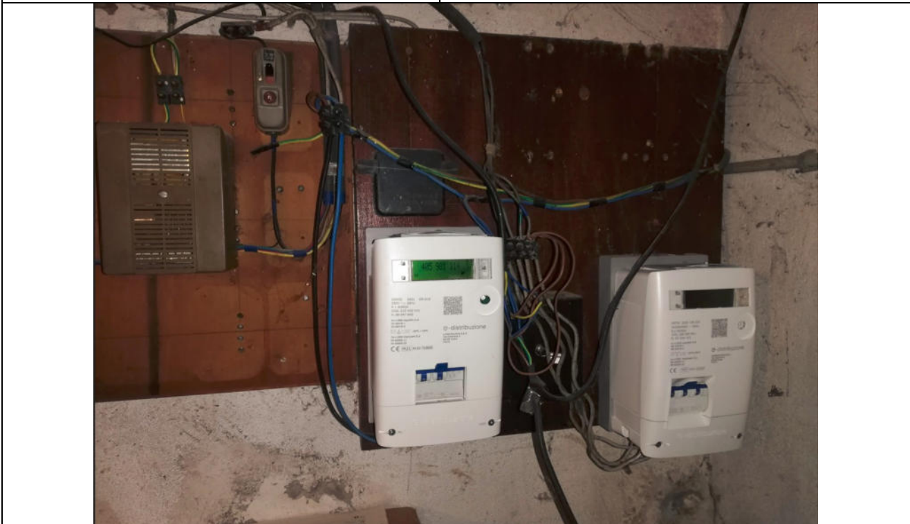
CONTATORI ELETTRICI PRESENTI IN CANTINA
