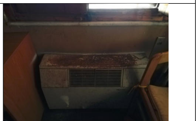
Impianto di riscaldamento
