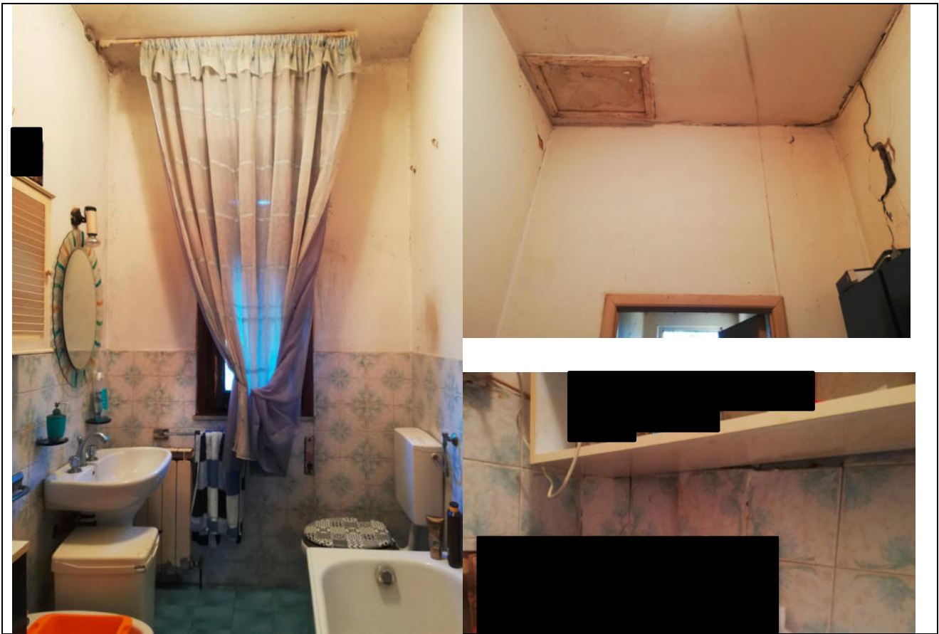
Bagno con accesso al sottotetto da botola e crepa vistosa a parete e dietro al rivestimento in ceramica
