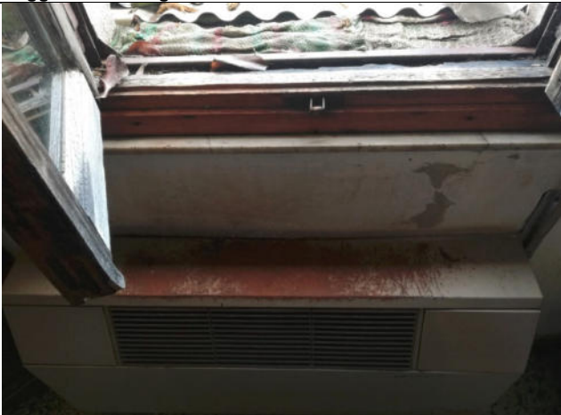
Impianto di riscaldamento
