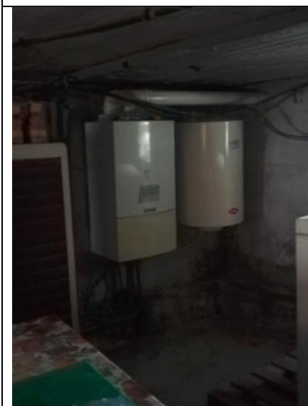
Tubo di espulsione fumi caldaia su parete esterna
