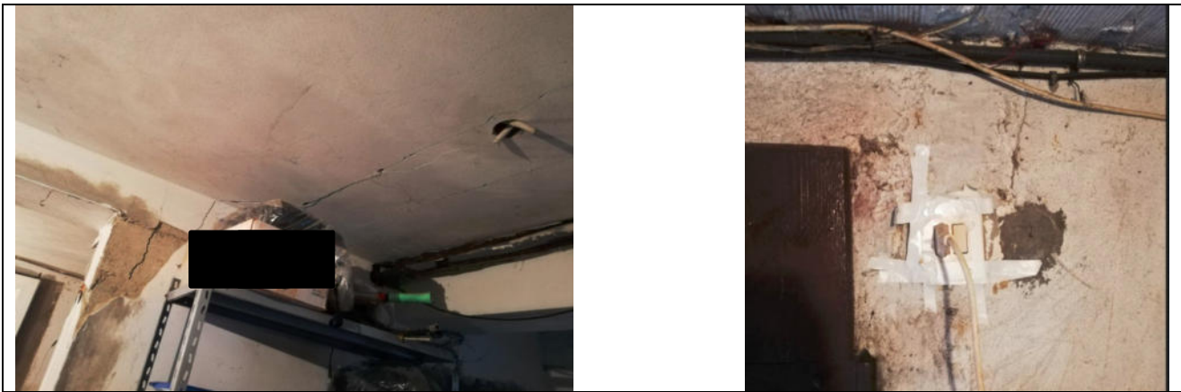
CREPA SU SOFFITTO CANTINA 3
