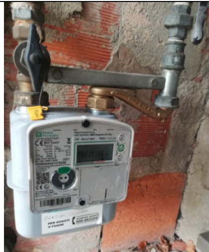
CONTATORE GAS METANO SOTTO SOTTOSCALE ESTERNO
