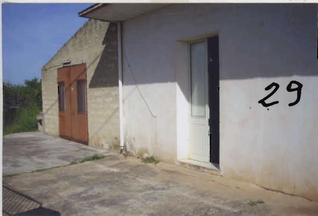
Recuperto principale del fabbricato di proprietà Meli Giovanni.
