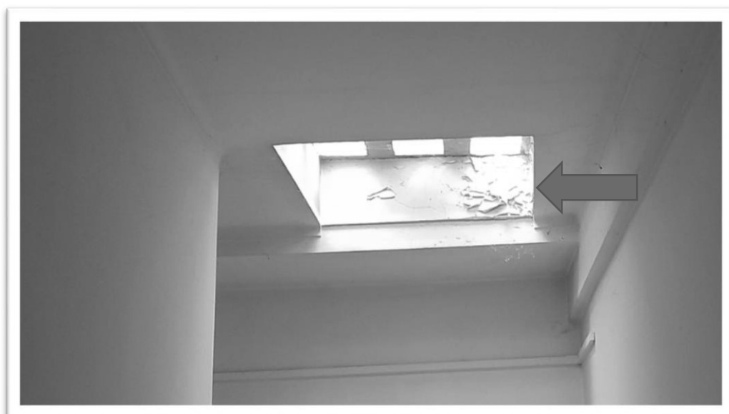
FOTOGRAMMA N. 3 - La muratura a ridosso del lucernaio della scala è risultata macchiata
