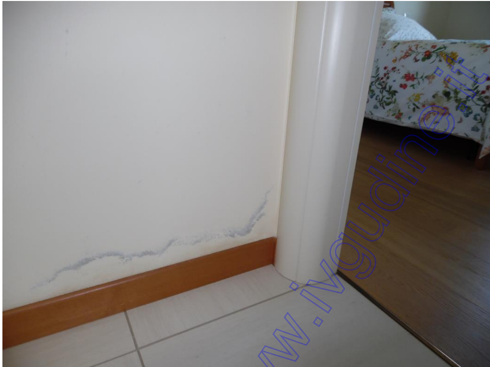
Umidità di risalita muratura interna, disimpegno zona notte – p.T
