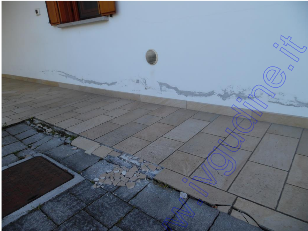
Umidità di risalita muratura esterna ad Est – Rottura piano di calpestio marciapiedi
