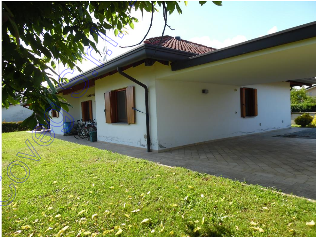
Umidità di risalita muratura esterna a Sud ed Est
