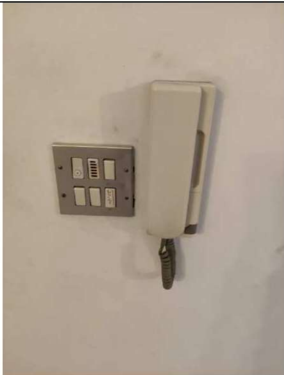
FOTO n. 44: particolare citofono e interruttori elettrici
