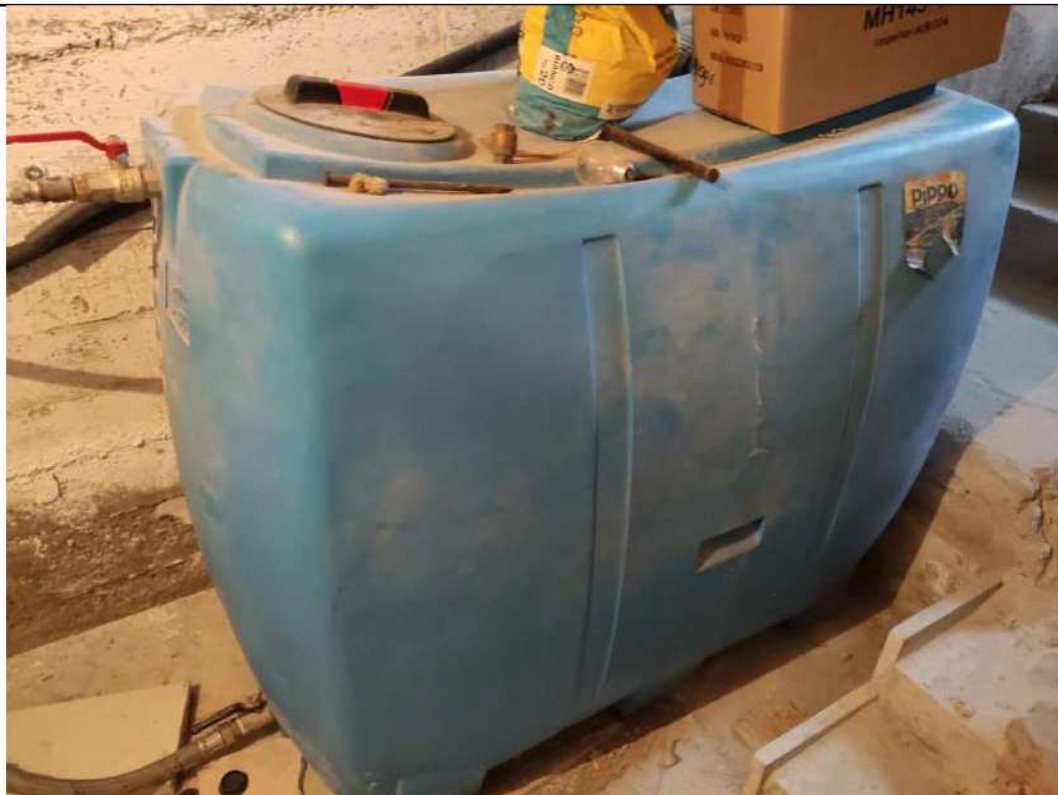
FOTO n. 46: particolare serbatoio acqua con autoclave posto al piano interrato
