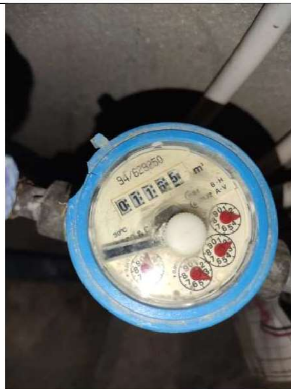
FOTO n. 48: particolare contatore acqua al piano interrato
