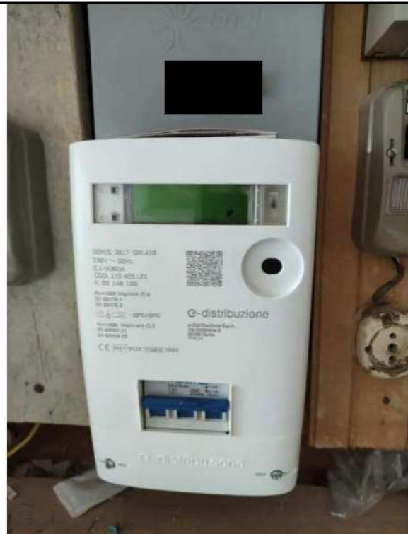
FOTO n. 45: particolare contatore energia elettrica
