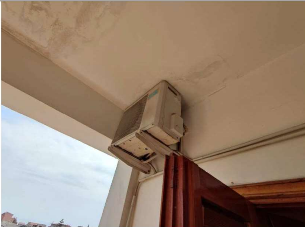
FOTO n. 43: particolare motore condizionatori - non funzionanti
