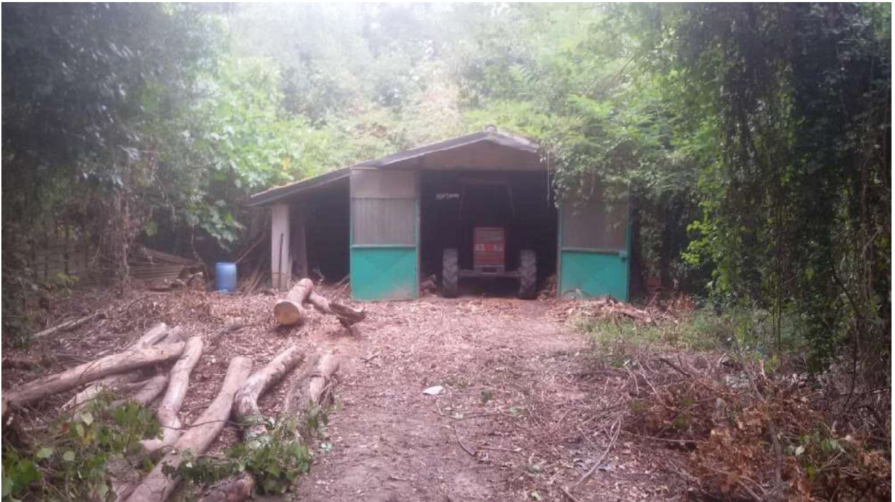
Annesso ad uso magazzino – la porzione laterale è crollata (F. 47 part.372)
