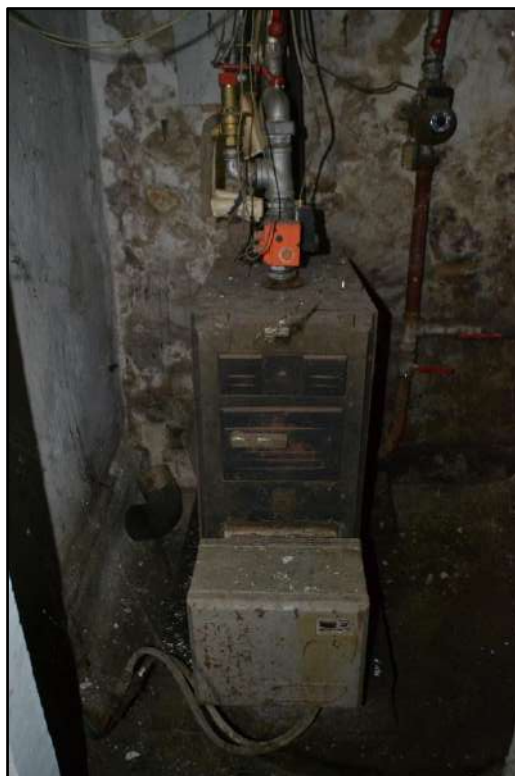
28. Caldaia Riello nel locale tecnico in cantina
