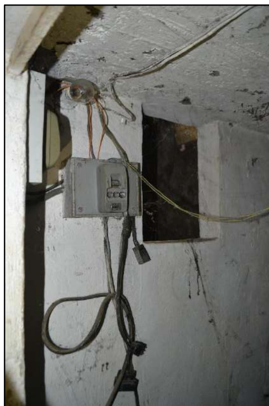
30. Impianto elettrico caldaia nel locale tecnico
