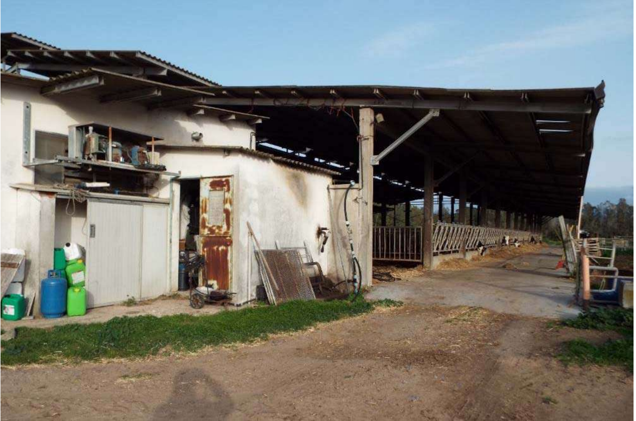
Figura n. 30: stalla e locale pompe
