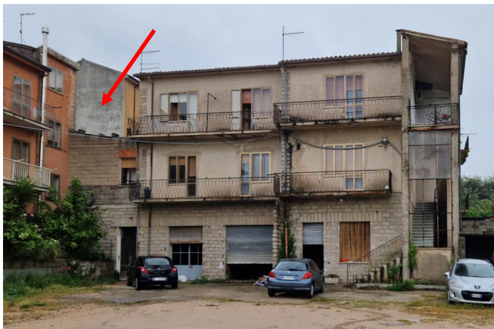
Stato attuale dell'immobile, la freccia rossa ad indicare la parte mancante
