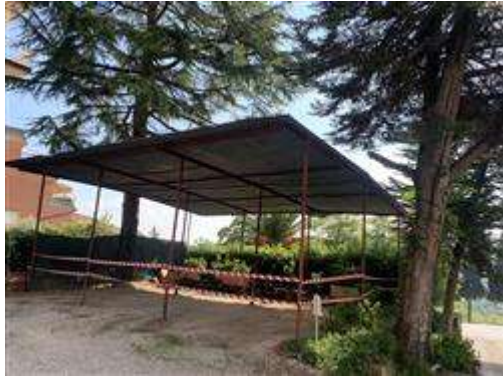
Tettoia non autorizzata
