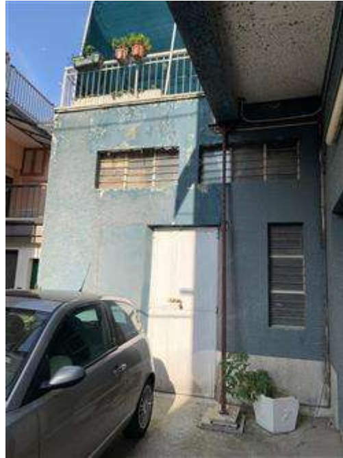
Locale centrale elettrica
