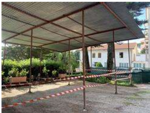
Tettoia non autorizzata
