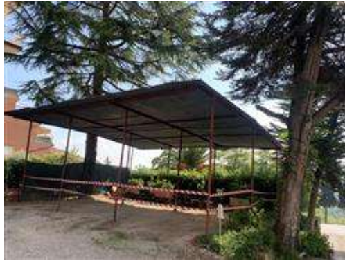
Tettoia non autorizzata
