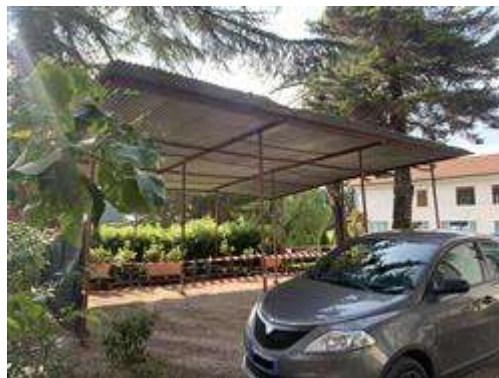
Tettoia non autorizzata
