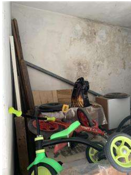
Locale centrale elettrica
