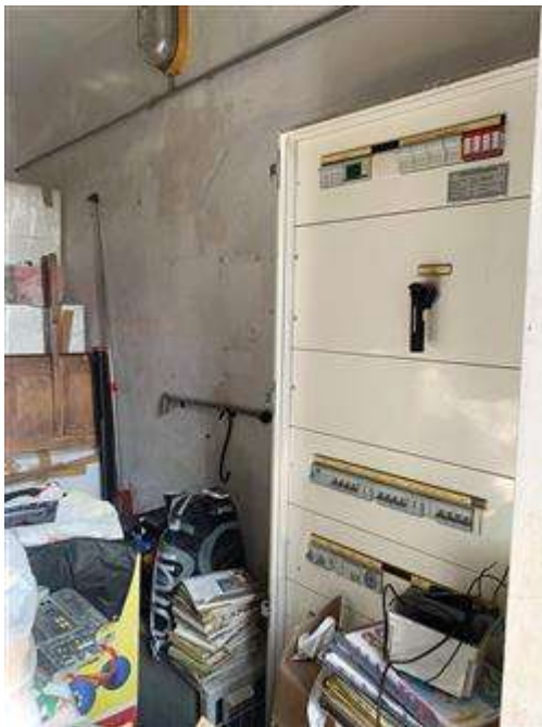
Locale centrale elettrica
