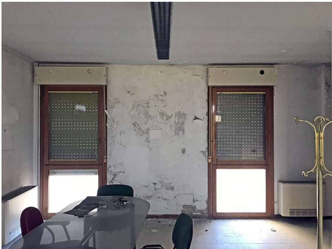
La parete ad est dell'ufficio sub60 con i problemi di infiltrazione.
