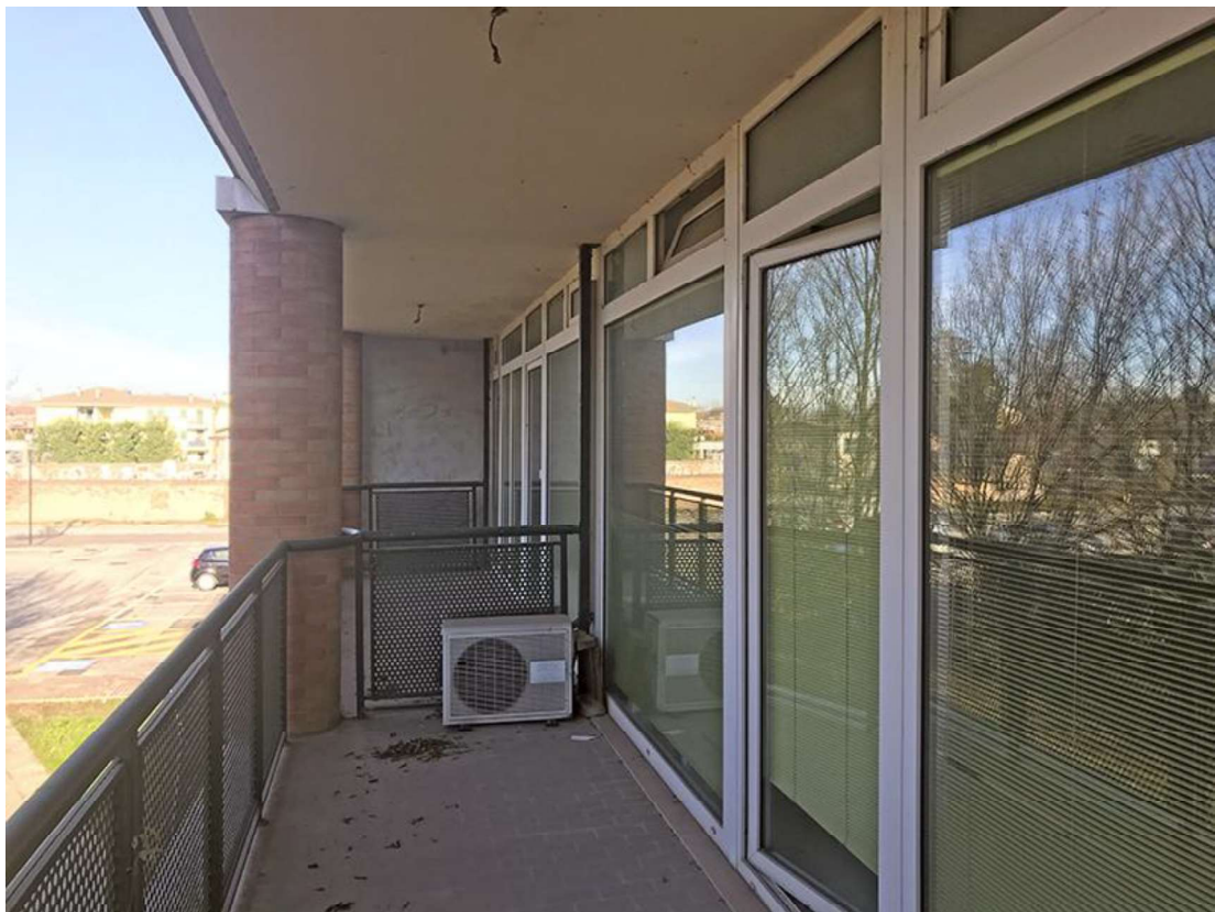
La loggia degli uffici sub61 e sub60 con le macchine per la climatizzazione.
