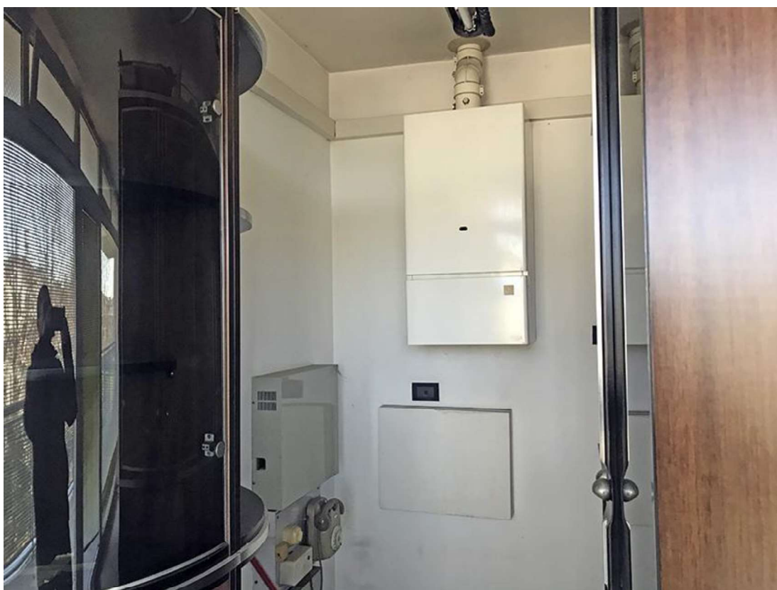
L'ufficio sub61 e la caldaia posta all'interno.
