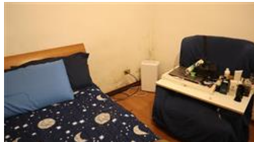
camera da letto, presenza di muffa e umidità
