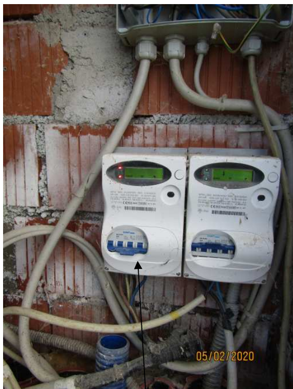
Punto di fornitura immobile
