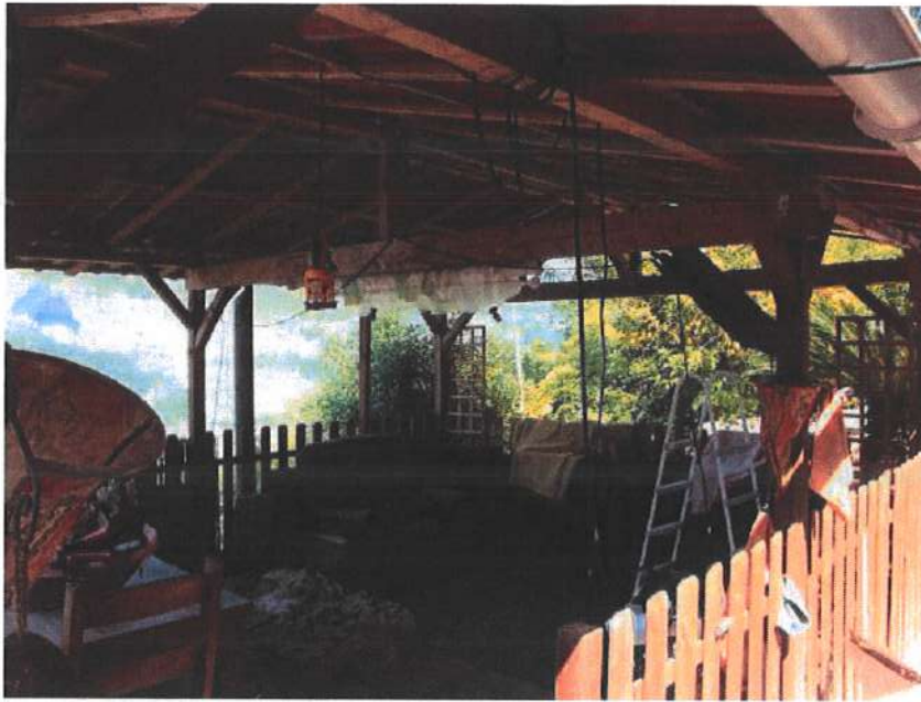
Foto n.21 – tettoia NON regolare
