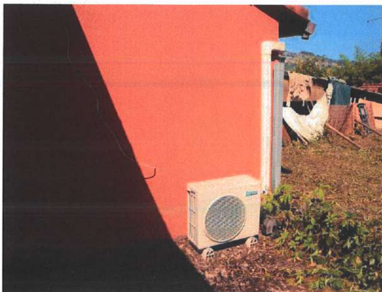
Foto n.13 – abitazione ed unità esterna
