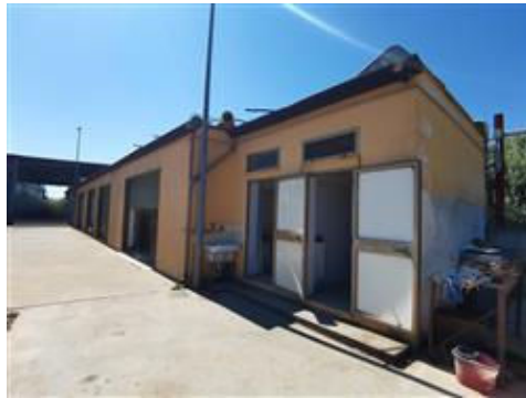
Fabbricato F1 all'interno della particella 502 realizzato senza titoli autorizzativi
