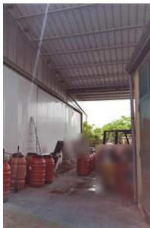
Foto 2 - Tettoia realizzata senza titoli autorizzativi sul lato Sud del fabbricato
