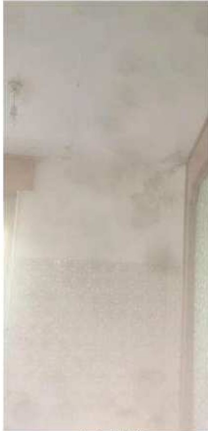
macchie di umidità diffuse
