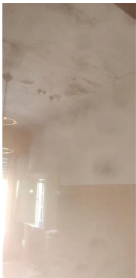
presenza di umidità sul soffitto
