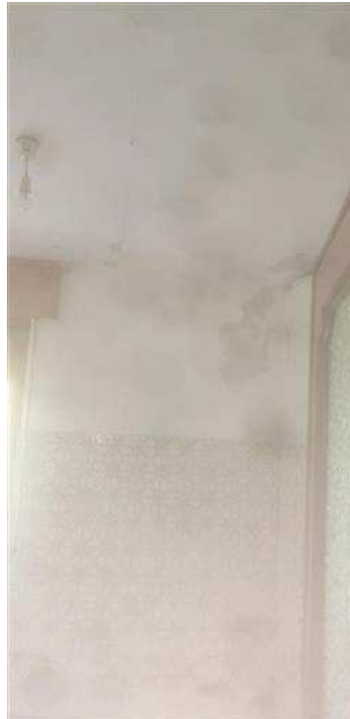
macchie di umidità diffuse
