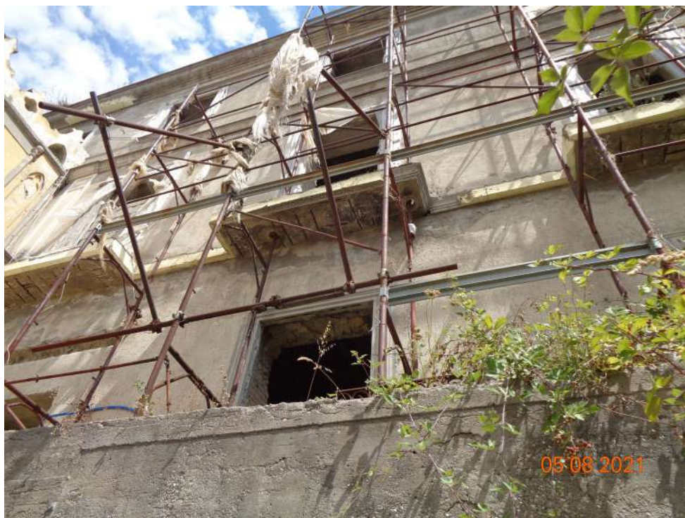
La foto n.03 mostra altro dettaglio della facciata Sud (panoramica) con gli aggetti dei balconi e gli stampi della cornice di marcapiano.
