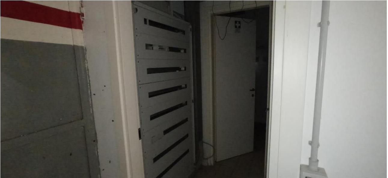
Foto n. 10. Piano terra, zona "laboratorio". Quadri elettrici privi di elementi
