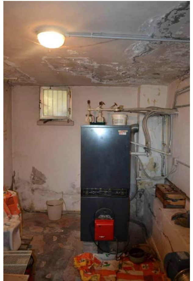
foto 34 - m.n. 378 - sub 1 (centrale termica) - Il generatore è una caldaia a bruciatore marca Riello, di cui non sono note l'epoca d'installazione, l'eventuale posizione CIRCE né la manutenzione.
