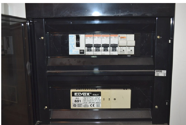
foto 31 - sub 1 (ingresso 1p) – Il quadro elettrico dell'appartamento al primo piano alloggia un differenziale con I_{\Delta n} = 0.03A , due magnetotermici C16 e due C10, nonché un portafusibili. Malgrado gli impianti risalgano a prima dell'introduzione della legge n. 46 del 05/03/1990, la rispondenza delle installazioni si può senz'altro dichiarare a cura di tecnico abilitato.
