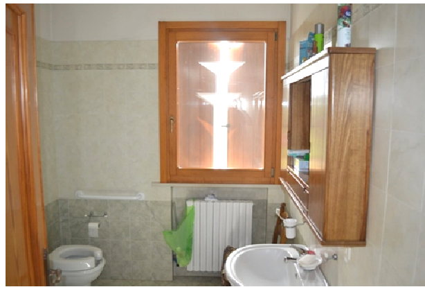
foto 20 - sub 2 (bagno 2) - Questo bagno è attrezzato per consentire la fruizione a utenti portatori di handicap. Nelle planimetrie agli atti non figura. Vi si trovano lavabo, wc, doccia e bidet. Piastr. h 2.30m.
