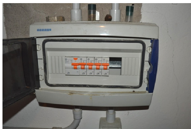
foto 32 - sub 1 (centrale termica) – Qui nel quadro elettrico si trovano un differenziale con I_{\Delta n} = 0.03A , un magnetotermico C16 e tre C10, ancora conformi alla norma di buona tecnica e dichiarabili ad essa rispondenti.
