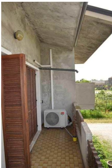
foto 9 - sub 1 (poggiolo 2) - La macchina frigo qui installata ha la targa di cui alla foto 16 esterna.
