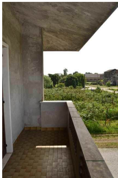
foto 10 - sub 1 (poggiolo 3) - Le pareti d'ambito sono prive di isolamento termico.-
