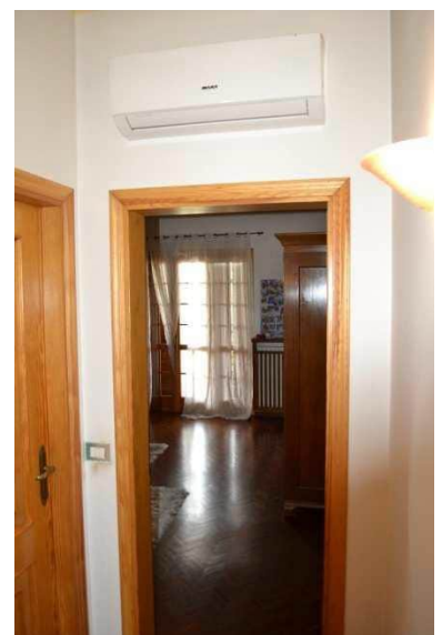
foto 14 - sub 1 (disimp.) - Sopra la porta del letto 1 si vede uno dei due clima alimentati dalla macchina di cui in foto 9.
