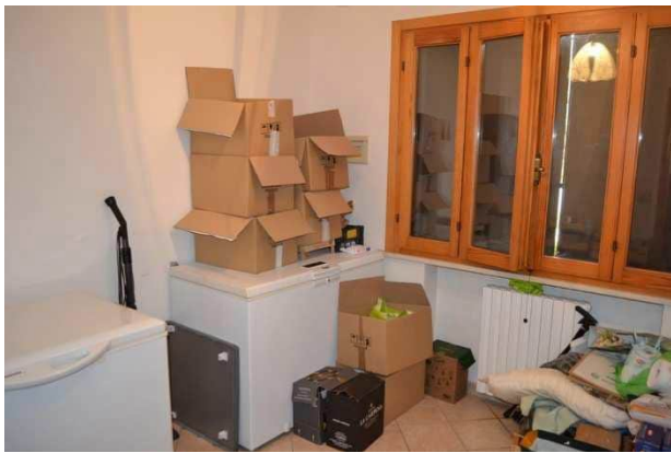
foto 19 - sub 2 (ripostiglio) – L'ambiente, riscaldato mediante corpi radianti di epoca più recente rispetto a quella dei termosifoni al piano superiore, non raggiunge i 9 m 2 ma è comunque di comoda ampiezza.
