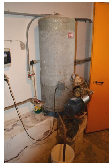
foto 30 - sub 1 (centrale term.) - L'acqua è prelevata da pozzo tramite autoclave e accumulata in un serbatoio da 200 lt. di capienza.
