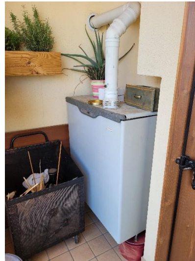
CENTRALE TERMICA ESTERNA
