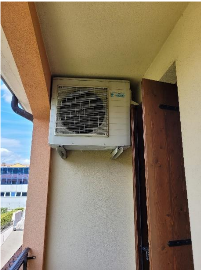
LOGGIA CON IMPIANTO CONDIZIONATORE
