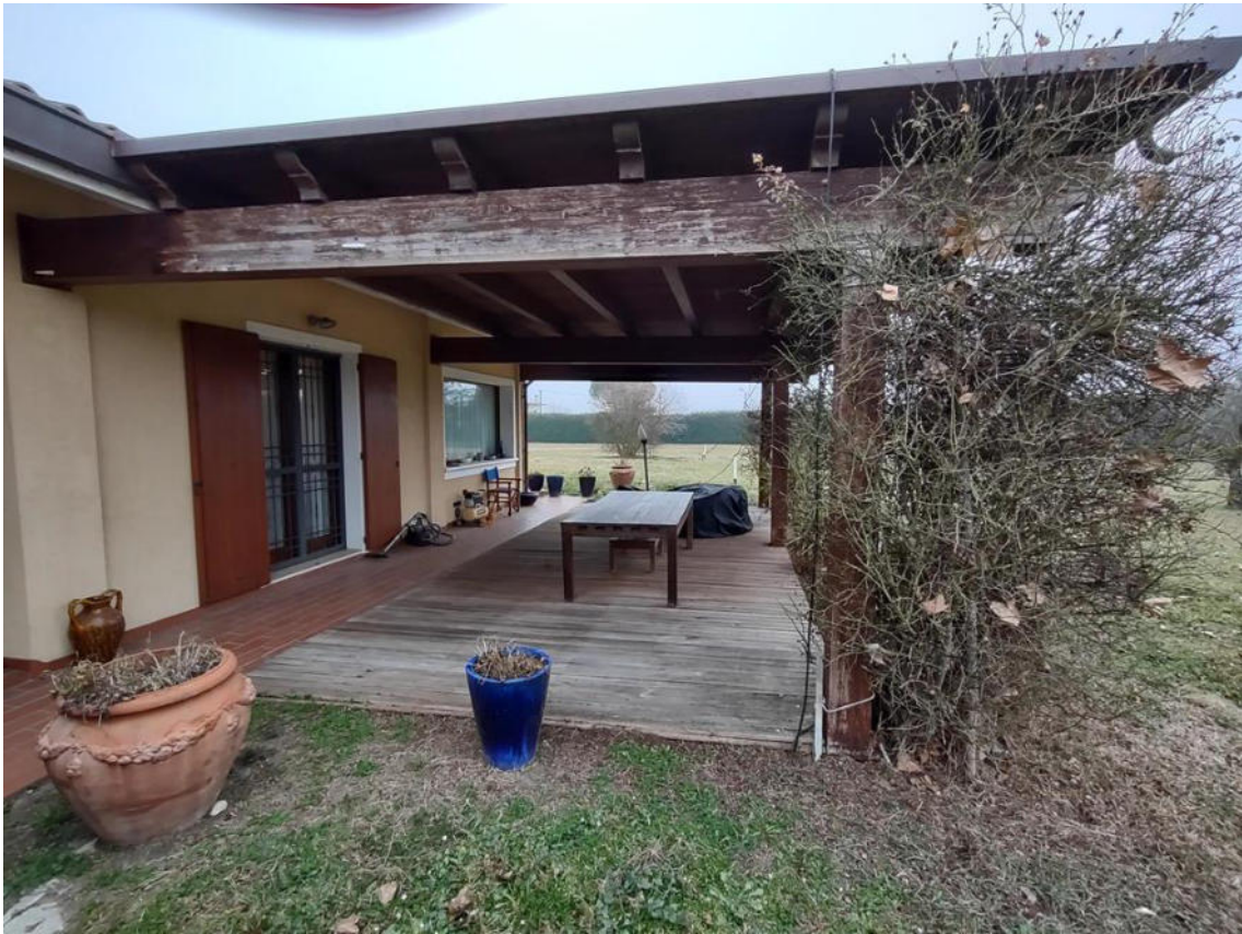
FOTO 7. La tettoia in legno ( non autorizzata) addossata al prospetto sud
