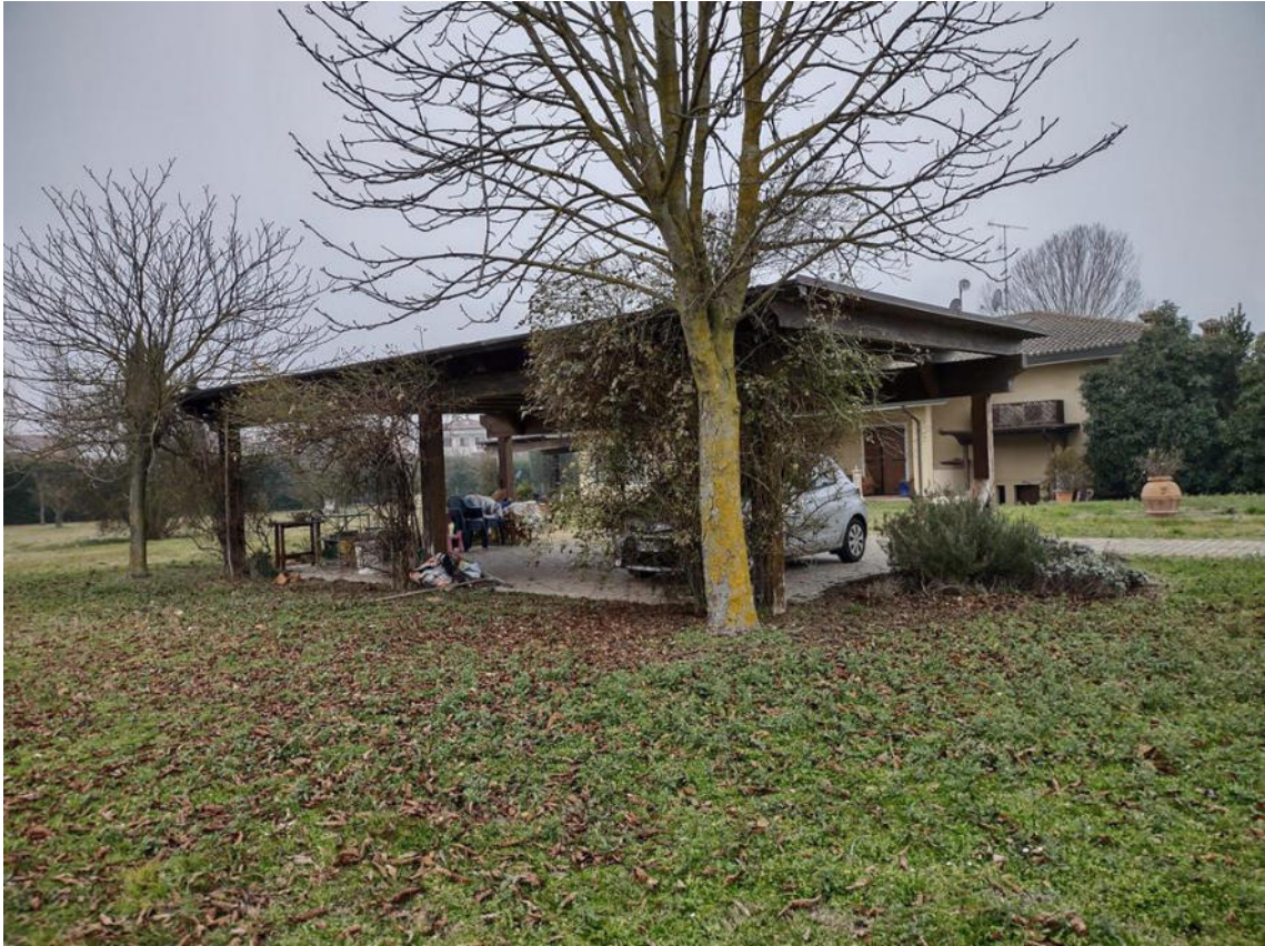
FOTO 5. La tettoia (non autorizzata) sull'area parcheggio
