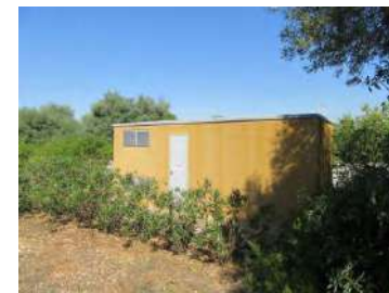
Foto da 45 a 48 – Cabina elettrica
