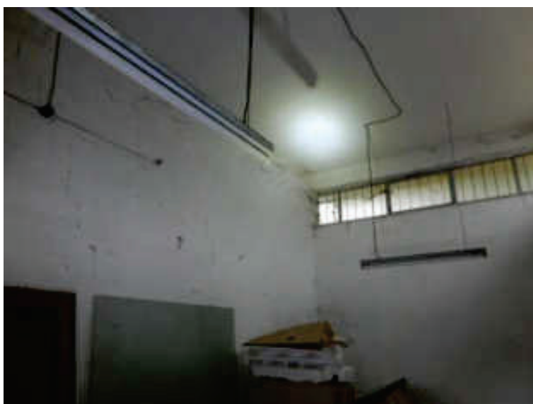
Foto n° 59 – particolare spigolo tra sub. n. 8 e sub. n. 7 – Foto 27.02.2023
