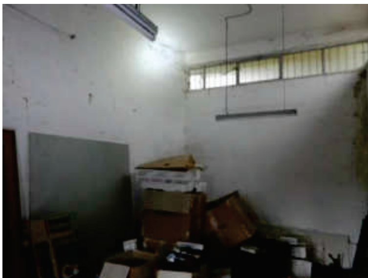
Foto n° 57 – particolare spigolo tra sub. n. 8 e sub. n. 7 – Foto 27.02.2023
