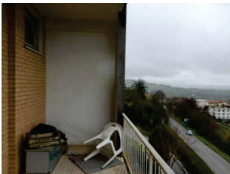
Foto n° 42 – spigolo Nord balcone parete Nord-Est – Foto 27.02.2023
