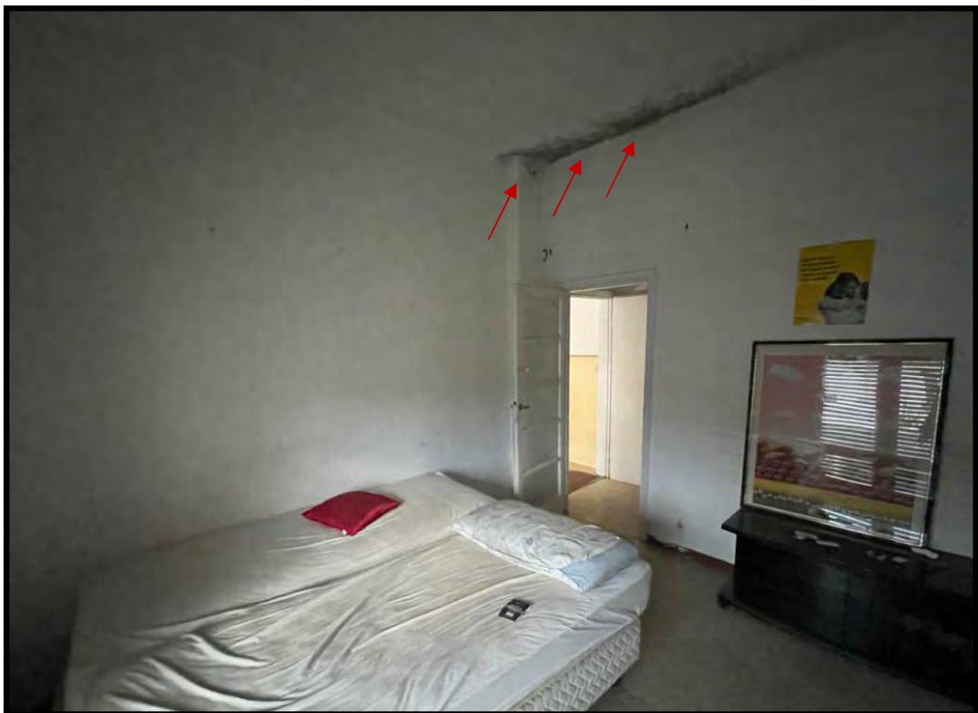
Camera –dettaglio plafone ammalorato
