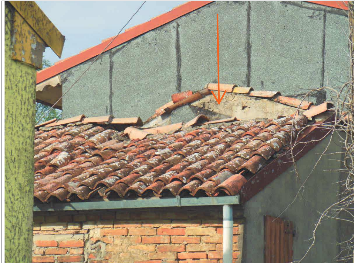
CROLLO PARZIALE TETTO
