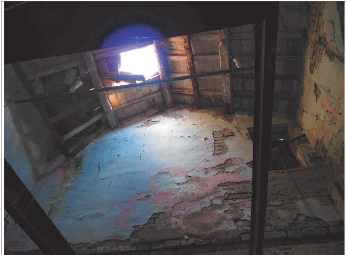
INTERNO MAGAZZINI P. TERRA MAPP. [REDAZIONE] (TETTO E SOLAIO CROLLATI)
