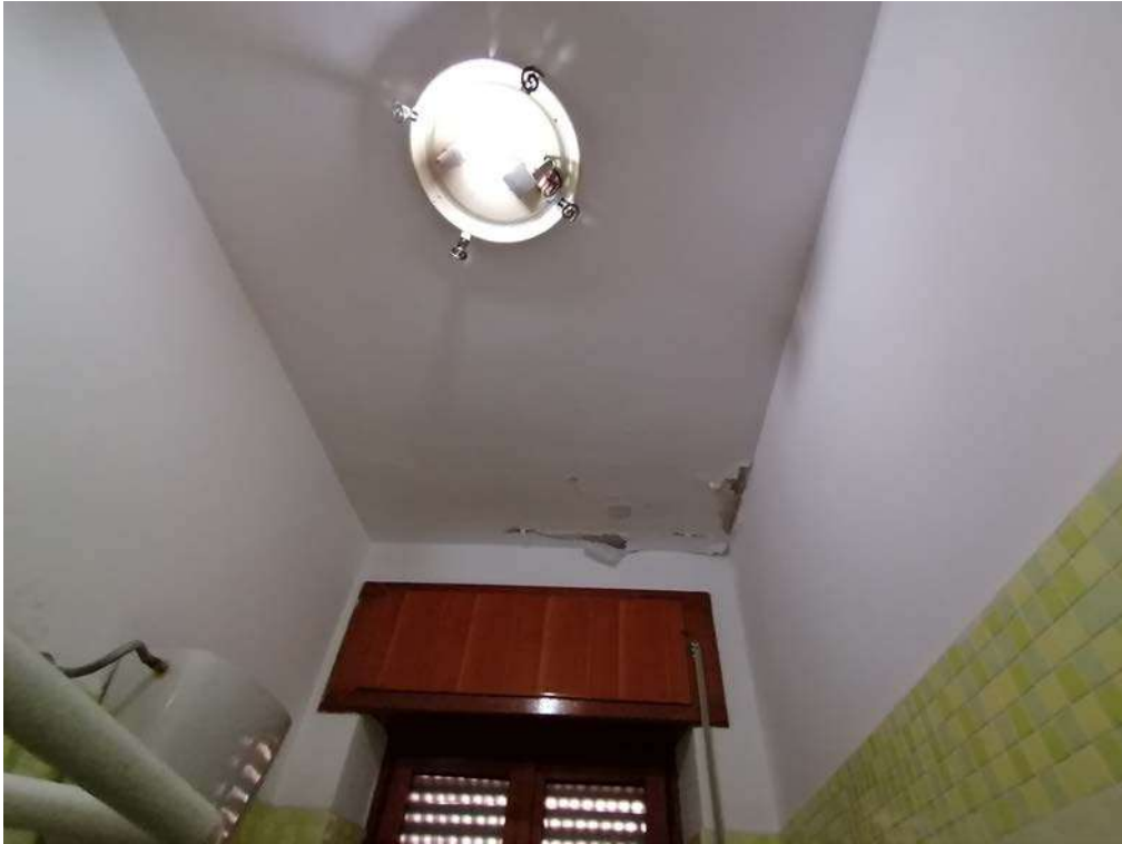
Infiltrazioni sulla volta del bagno al primo piano
