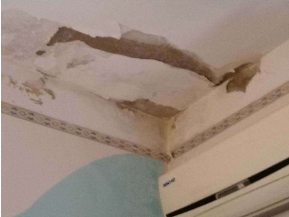
Infiltrazioni sulla volta al primo piano
