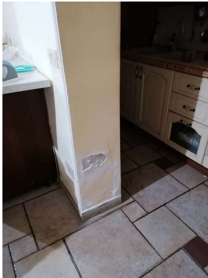
Risalita di umidità al piano terra
