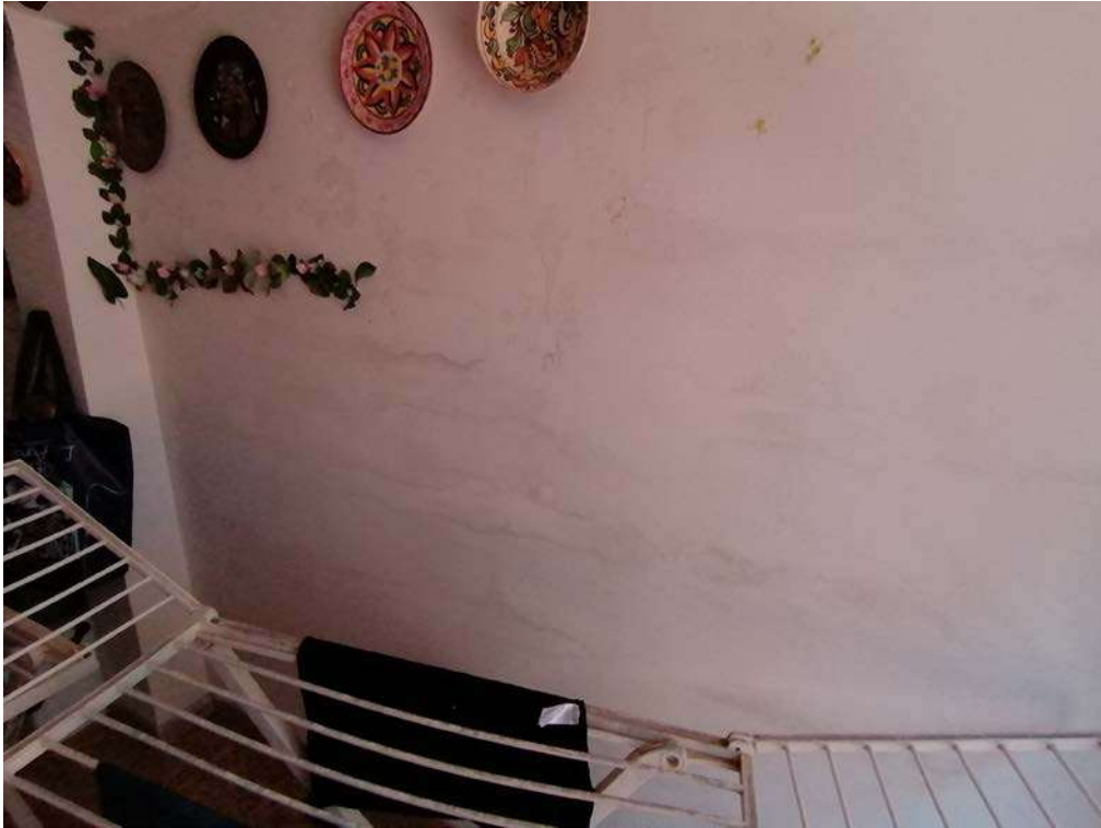
Macchie di umidità in soffitta al secondo piano
