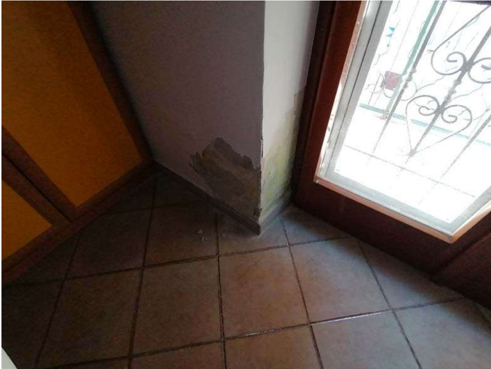
Distacchi di intonaco al primo piano lungo le pareti
