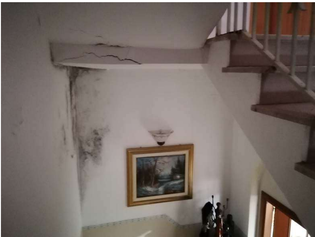
Macchie di umidità e lesioni nella scalinata
