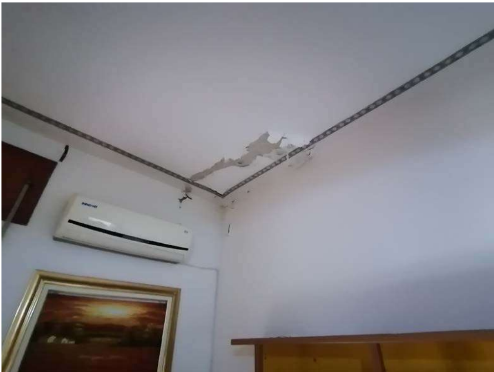
Infiltrazioni sulla volta al primo piano
