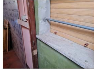
FOTO 66 - DETTAGLIO INTERNO TETTOIA NON CONFORME SUL RETRO
