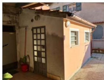
FOTO 24 - AMPLIAMENTO A PIANO TERRA NON CONFORME
