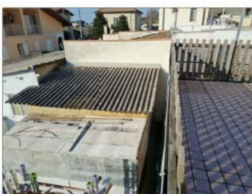
FOTO 26 - TAMPONAMENTI TETTOIE A PIANO TERRA NON CONFORMI
