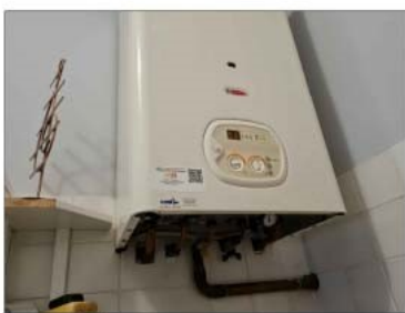
FOTO 70 - CALDAIA PIANO PRIMO
