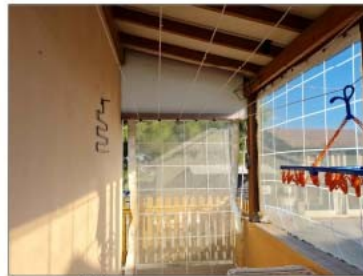
FOTO 50 - VERANDA CHIUSA NON CONFORME
