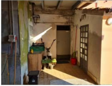
FOTO 31 - CENTRALE TERMICA A PIANO TERRA
