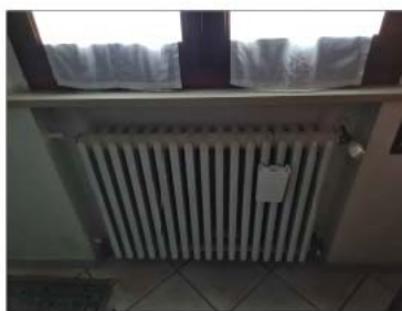
FOTO 71 - PIANO TERRA RADIATORE IN NICCHIA SOTTO FINESTRA
