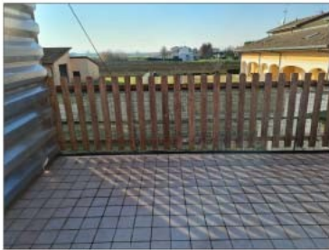
FOTO 28 - TERRAZZO NON CONFORME
