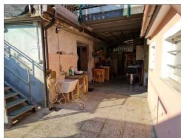
FOTO 18 - TETTOIA NON CONFORME CON TERRAZZO DI COLLEGAMENTO
