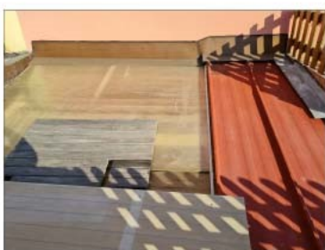
FOTO 27 - TAMPONAMENTI TETTOIE A PIANO TERRA NON CONFORMI
