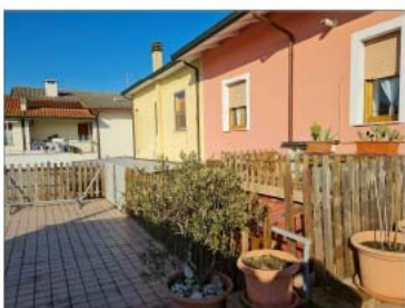
FOTO 21 - TERRAZZO E COPERTURE TETTOIE NON CONFORMI
