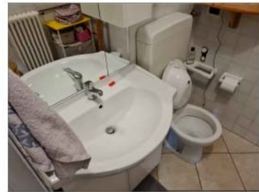
FOTO 51 - PIANO PRIMO BAGNO SECONDARIO NON CONFORME
