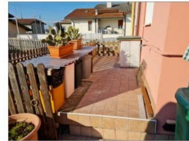
FOTO 30 - BALCONE NON CONFORME SUL FRONTE RETROSTANTE
