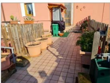
FOTO 20 - TERRAZZO NON CONFORME DI COLLEGAMENTO A PIANO PRIMO
