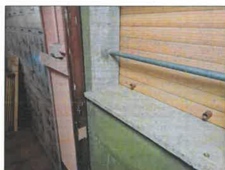
FOTO 66 - DETTAGLIO INTERNO TETTOIA NON CONFORME SUL RETRO
