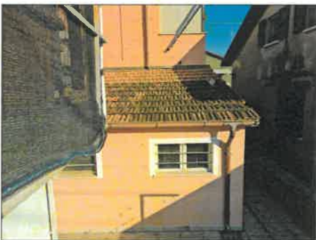
FOTO 19 - VISTA AMPLIAMENTO A PIANO TERRA NON CONFORME
