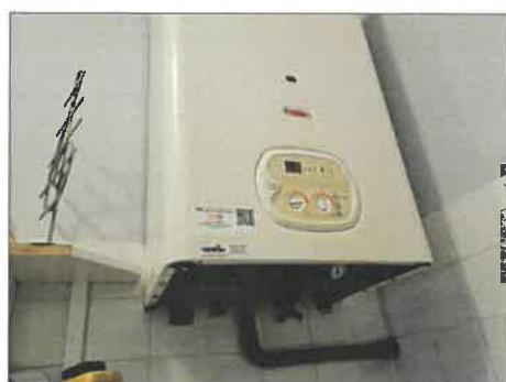
FOTO 70 - CALDAIA PIANO PRIMO
