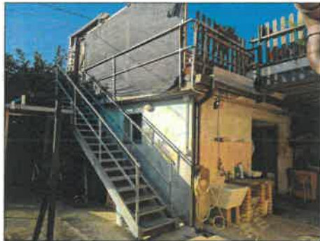
FOTO 17 - SERVIZIO NEL RETRO CON TERRAZZO NON CONFORME COPERTURA
