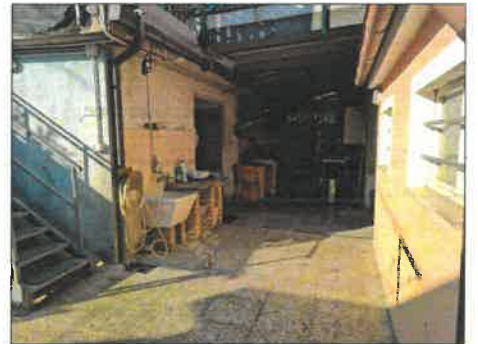
FOTO 18 - TETTOIA NON CONFORME CON TERRAZZO DI COLLEGAMENTO
