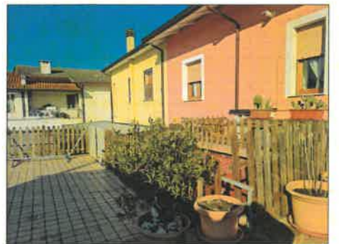
FOTO 21 - TERRAZZO E COPERTURE TETTOIE NON CONFORMI
