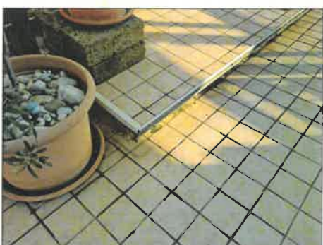
FOTO 68 - PIANO PRIMO DETTAGLI TERRAZZO NON CONFORME
