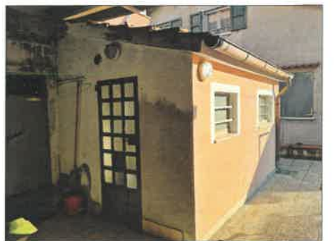
FOTO 24 - AMPLIAMENTO A PIANO TERRA NON CONFORME
