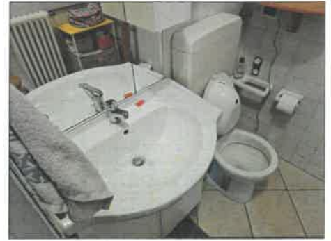
FOTO 51 - PIANO PRIMO BAGNO SECONDARIO NON CONFORME
