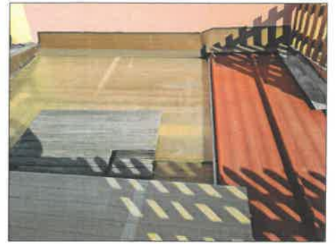
FOTO 27 - TAMPONAMENTI TETTOIE A PIANO TERRA NON CONFORMI
