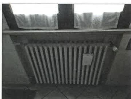
FOTO 71 - PIANO TERRA RADIATORE IN NICCHIA SOTTO FINESTRA
