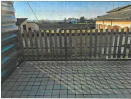
FOTO 28 - TERRAZZO NON CONFORME
