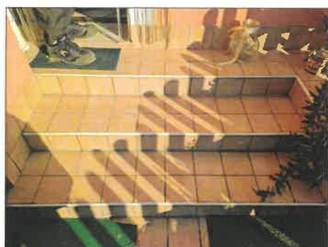
FOTO 67 - ACCESSO SUL TERRAZZO DI COLLEGAMENTO NON CONFORME
