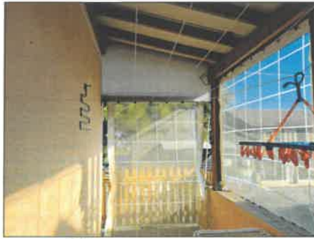
FOTO 50 - VERANDA CHIUSA NON CONFORME
