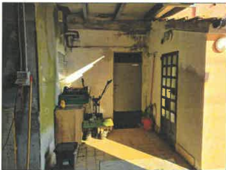
FOTO 31 - CENTRALE TERMICA A PIANO TERRA
