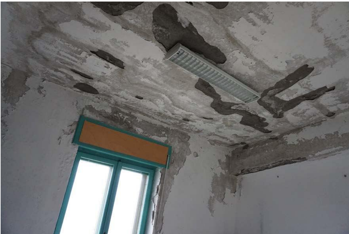
Fig.76 – Vista del degrado per infiltrazione del solaio vano dell’immobile sal ub.13 (A10)
