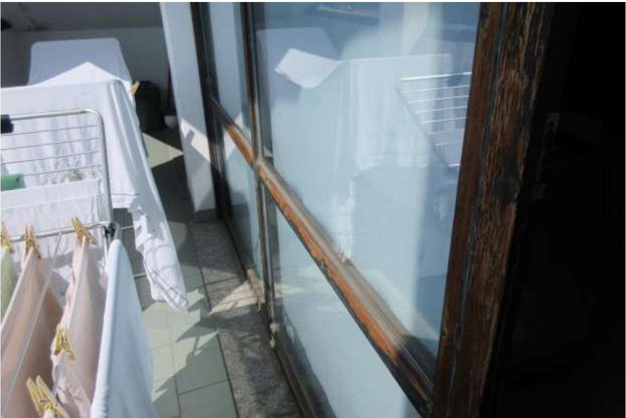
Particolare dei serramenti in legno in pessime condizioni di manutenzione e conservazione
