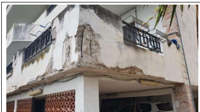
Foto n. 6. Scrostamento del balcone dell'alloggio pignorato.
