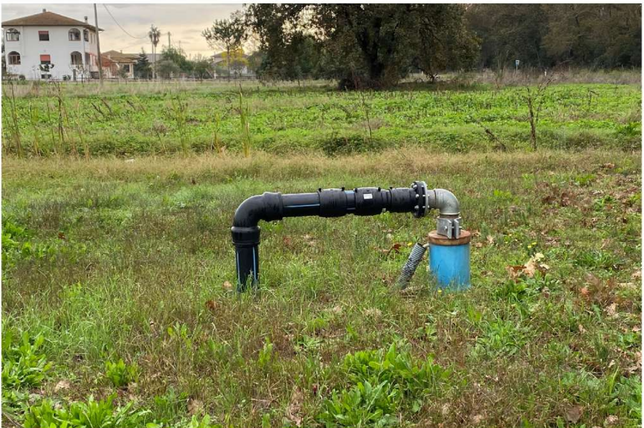
ESTERNO RAVVICINATO – DETTAGLIO POMPA E POZZO ARTESIANO
