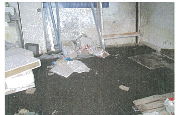
Foto n.21 Si evidenzia penetrazione di acqua piovana dal muro contro-terra e perimetrale.
