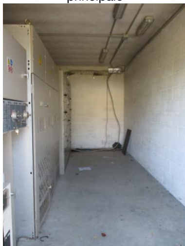
Vista interna PT (fabbricato 4) – Cabina elettrica
