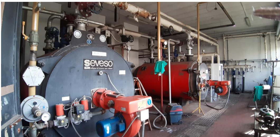
Blocco locali tecnici - Locale caldaie
