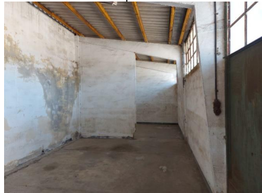
Vista interna PT (fabbricato 8) – Box
