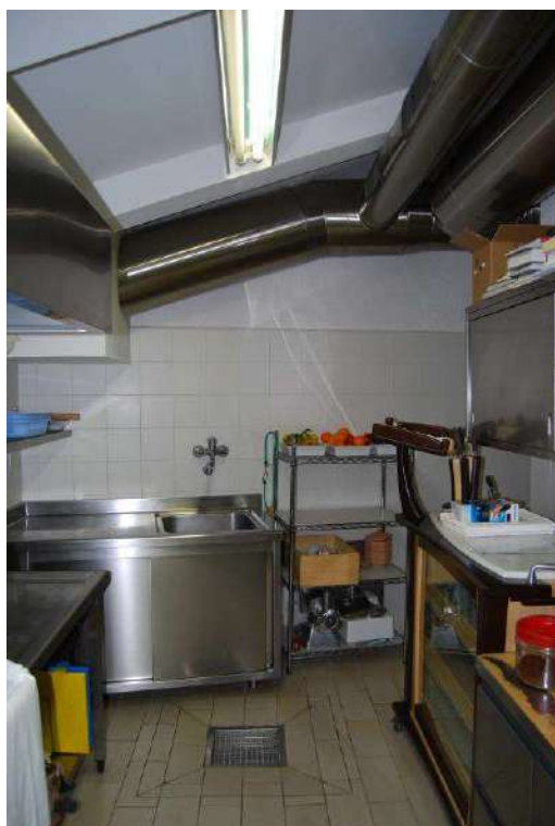
Cucina – Zona lavaggio sul retro
