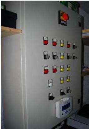
Quadro di controllo impianto
