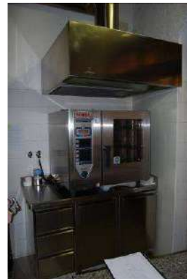
Una delle cappe aspiranti della cucina
