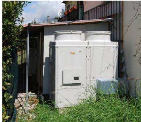
Pompa di calore
