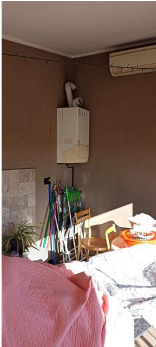
caldaia ubicata sul terrazzino
