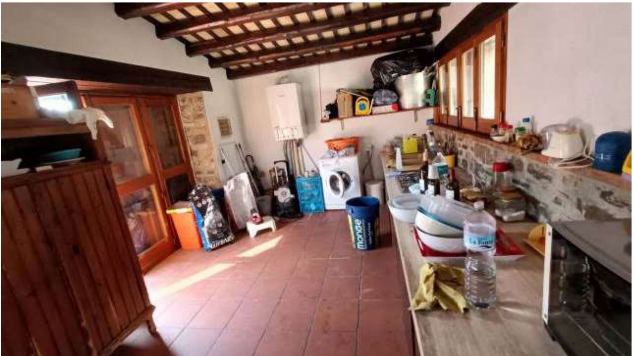
FOTO 28 – Locale cucina esterna (14), particolare della caldaia a servizio della villa
