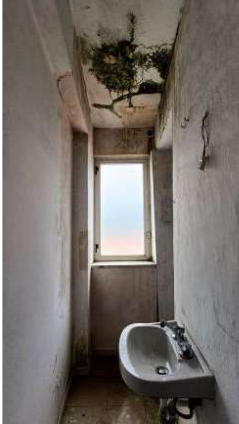
FOTO 9 – WC (4), particolare del soffitto ammalorato
