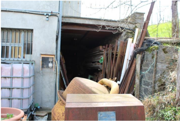
AMPLIAMENTO PER SOSTEGNO TERRAZZO AL PIANO SUPERIORE, NON REGOLARE, DA METTERE IN PRISTINO MEDIANTE DEMOLIZIONE
