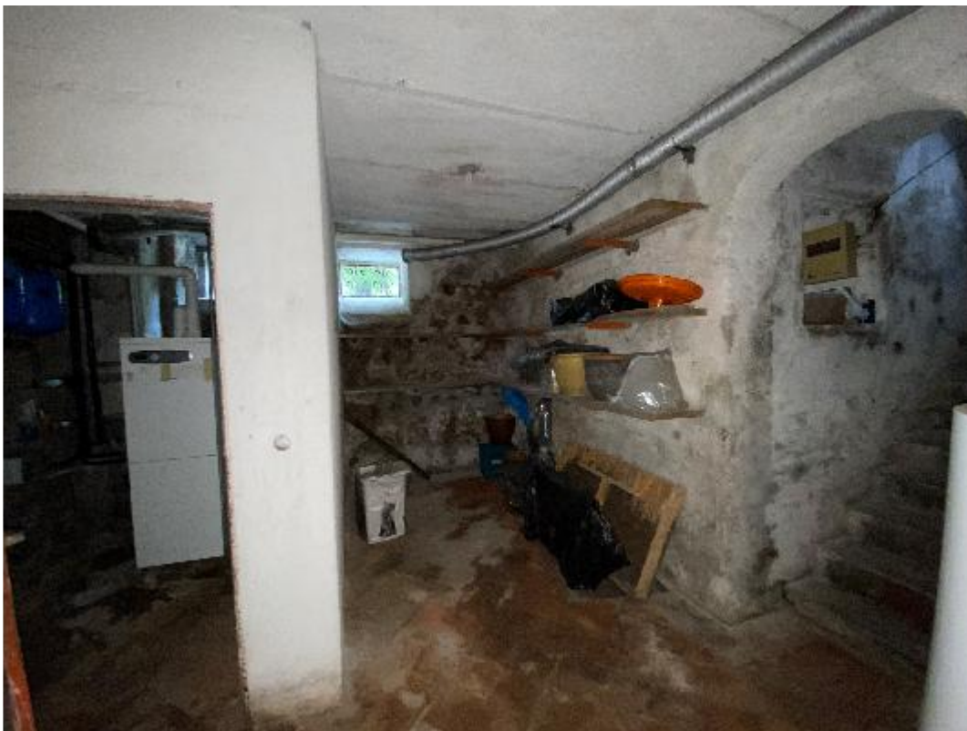
29. cantina con centrale termica
