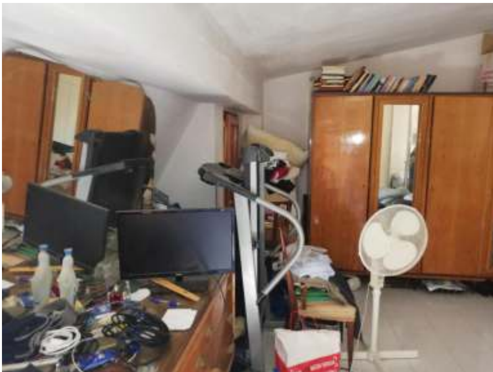
Foto 24: Umidità nella camera dell'ultimo livello ....
