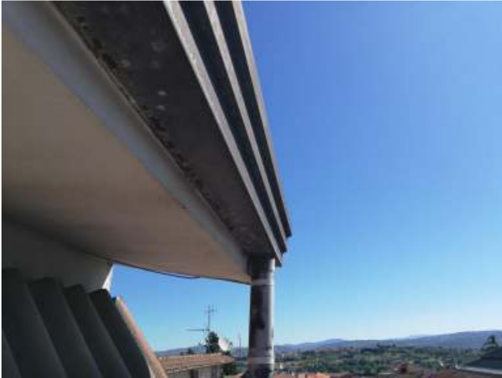
Foto 23: ... Inidoneità dei sistemi di smaltimento delle acque di pioggia ..
