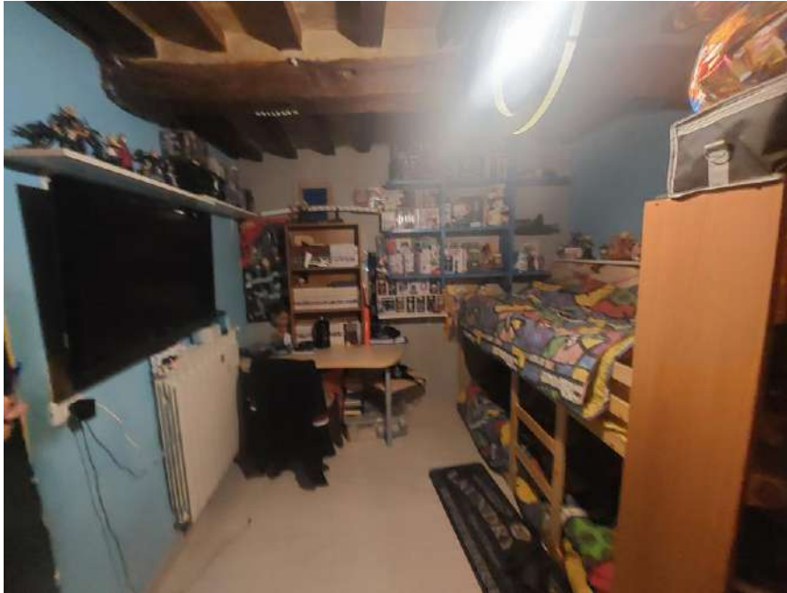
Foto n.13: Particolare della camera priva di finestre al piano primo. Sono visibili le pareti intonacate e tinteggiate, il pavimento in parquet, l'impianto elettrico sottotraccia e l'elemento radiante dell'impianto di riscaldamento in alluminio. Notare i solai con orditura in legno lamellare.
