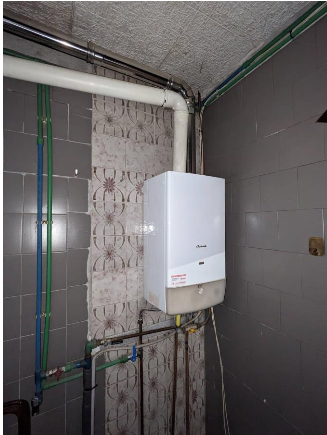
Immagine 11 - P.1 Locale Caldaia
