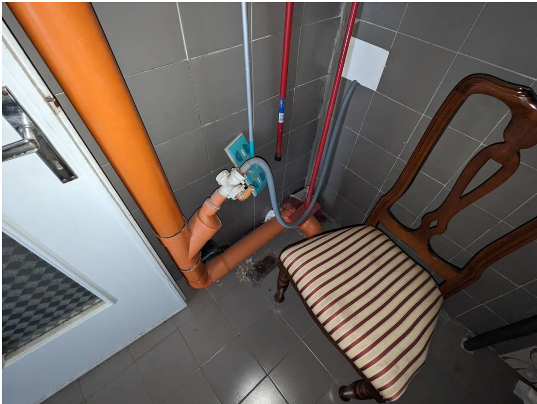
Immagine 12 - P.1 Locale Caldaia
