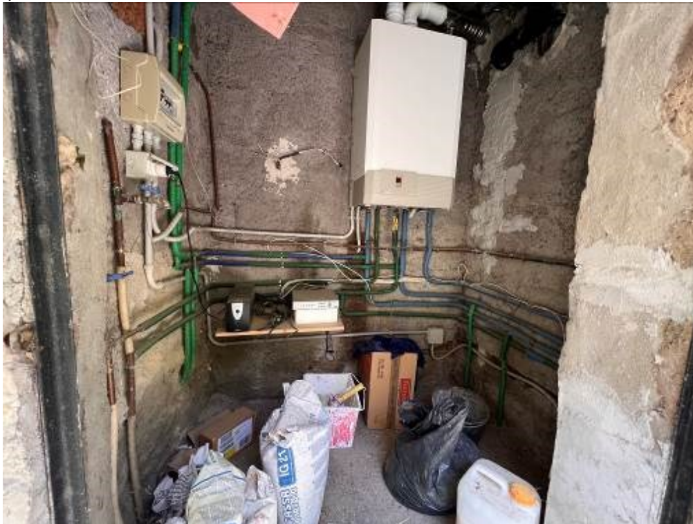
Lotto 1 Corpo A - Vista locale tecnico caldaia
