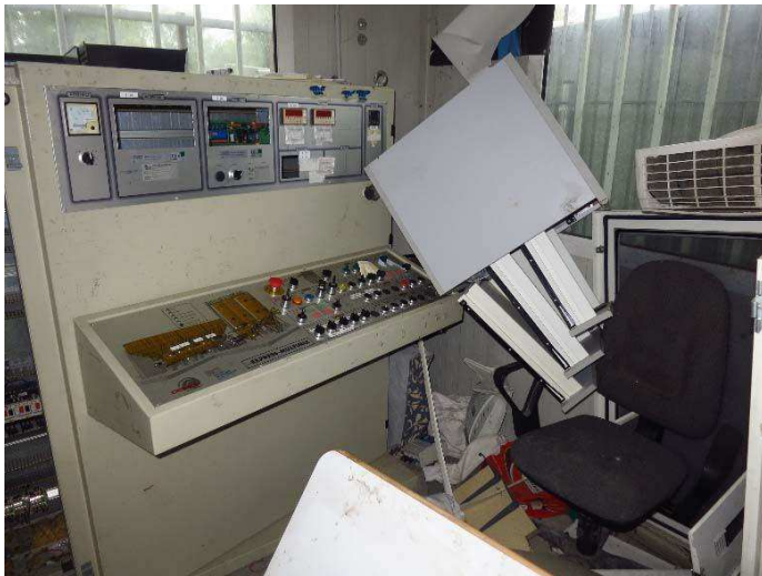
Impianto di produzione calcestruzzo.
